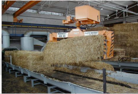
Žlutická teplárenská a.s. Cascade of boilers VERNER GOLEM
