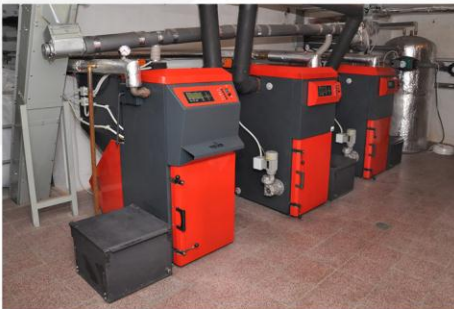
Pension Bejčkův Mlýn Cascade of automatic boilers VERNER
